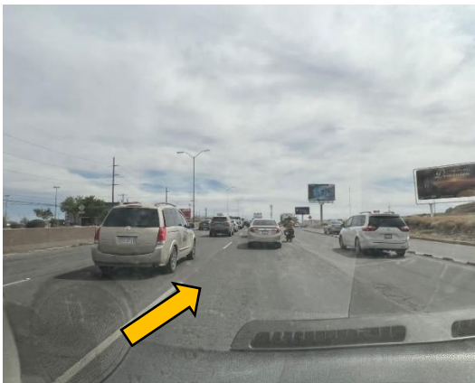
Área de la superficie de rodamiento dañada aún sin reparar.
