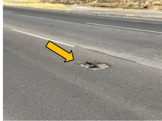
Tramo 3 Paso inferior Juan Escutia a Francisco Villa carril central, área de la superficie de rodamiento dañada aún sin reparar.
