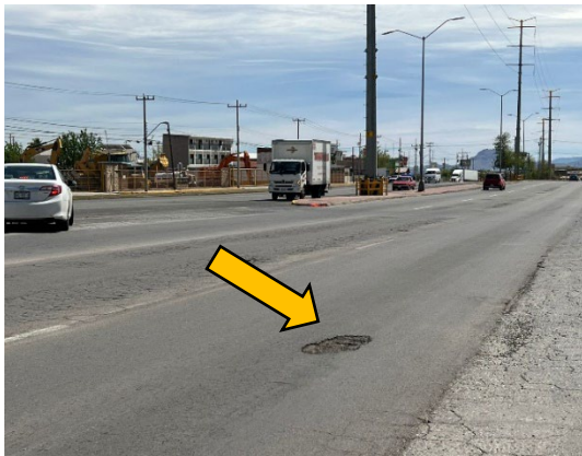
Tramo 6 Intermex Guillermo Prieto, área de la superficie de rodamiento dañada aún sin reparar.
