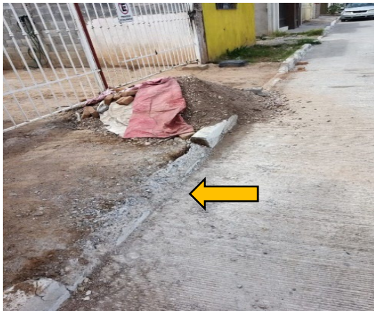
Guarnición destruida, en la Calle Desierto de Libia.
