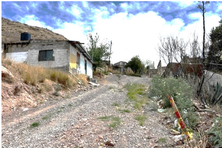
Tratamiento en las terracerías por medio de base hidráulica y riego de impregnación en mal estado en Calle Cerro de la Borrega.
