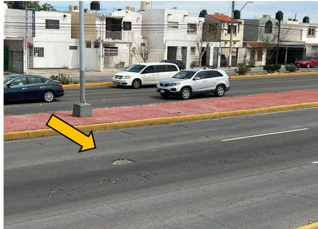
Tramo 7 norte sur Gaza Universitaria a distribuidor de la Av. Homero, área de la superficie de rodamiento dañada aún sin reparar.
