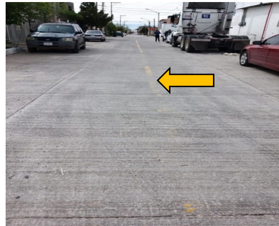
Pintura de tráfico amarilla deslavada, sobre pavimento en la Calle Desierto de Chalbi
