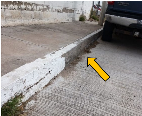
Desprendimiento de pintura en la guarnición, en la Calle Desierto de Libia.
