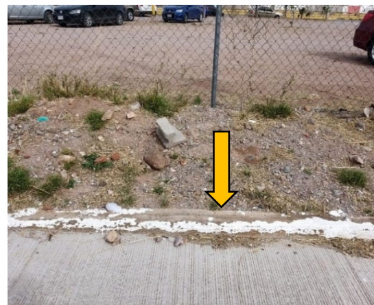
Desprendimiento de pintura de la guarnición, en la Calle Desierto de Libia.
