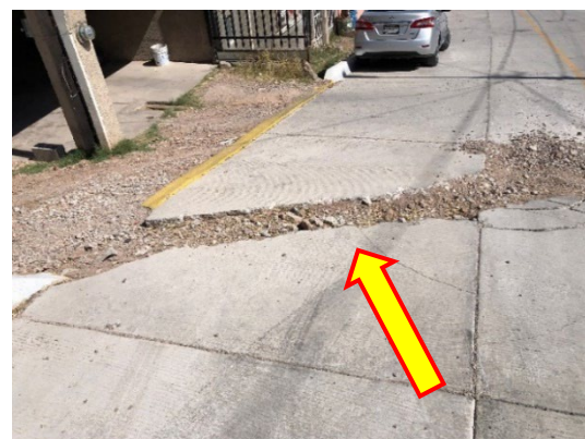
Excavación de la banqueta al centro de la calle, por no considerar la toma domiciliaria y la descarga sanitaria.
