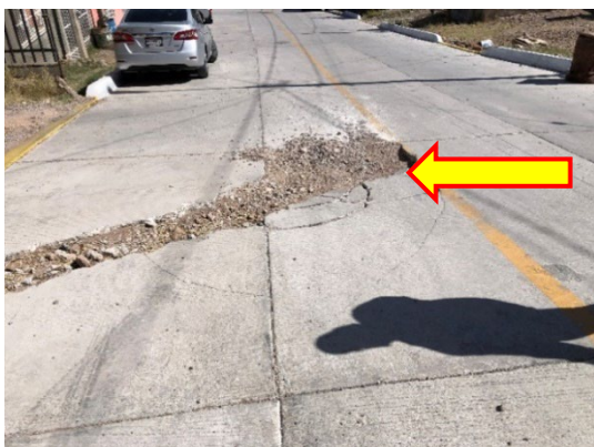
Excavación sobre la losa de concreto, por no considerar la toma domiciliaria y la descarga sanitaria.
