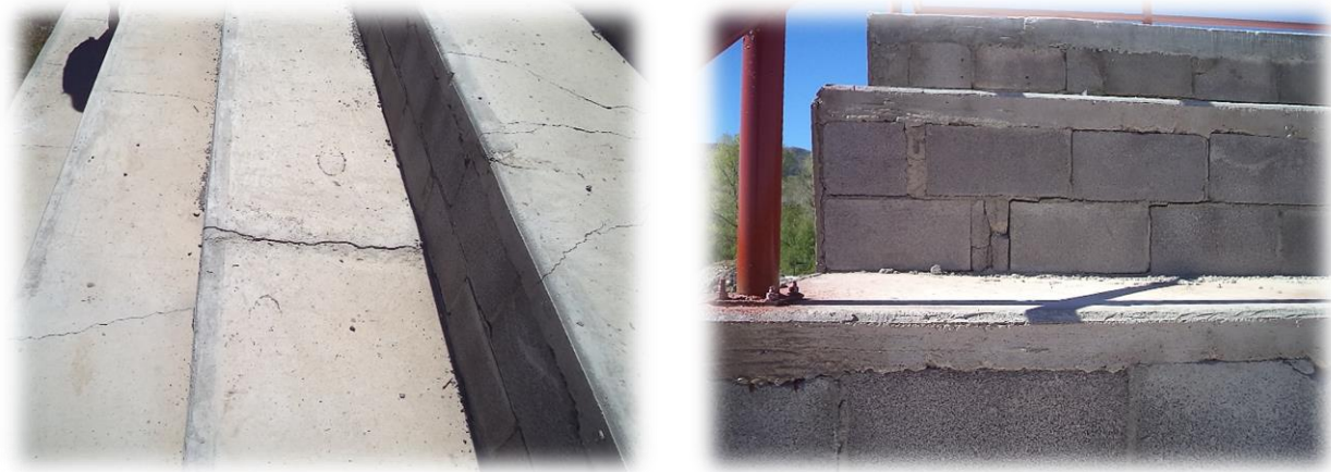
Fotografías de agrietamientos y desprendimientos.
