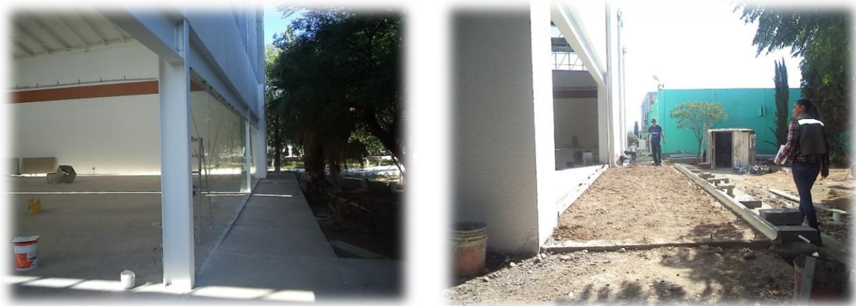
Fotografía de la cancelería en la que se aprecia la falta de los trabajos mencionados anteriormente
