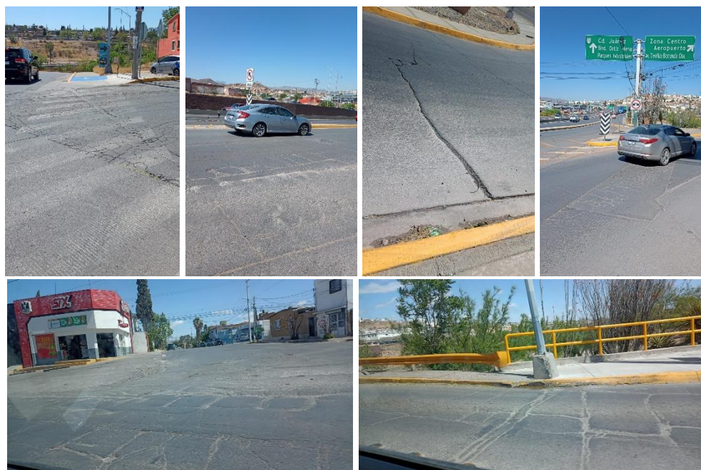
IMG. 45. Fallas en el pavimento.
