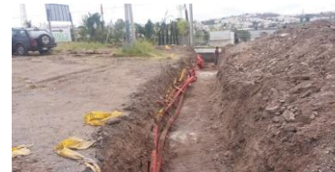
BAJARCUCE DE LINEA ELECTRICA DE C.F.E
