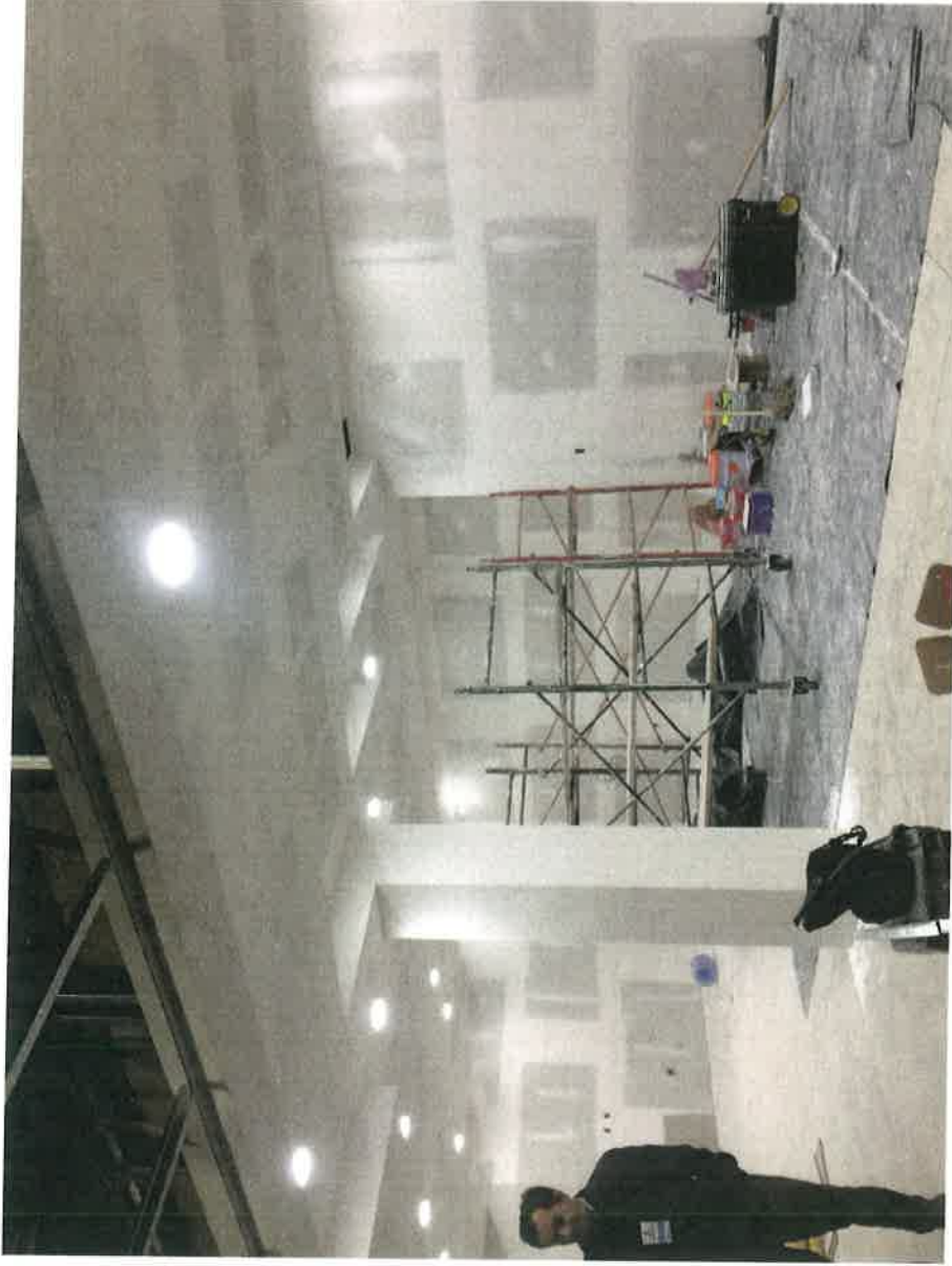
8.4.1.12. Sistema de control de alumbrado digital para el área de sala de juntas, incluye cableado UTP nivel 5.
