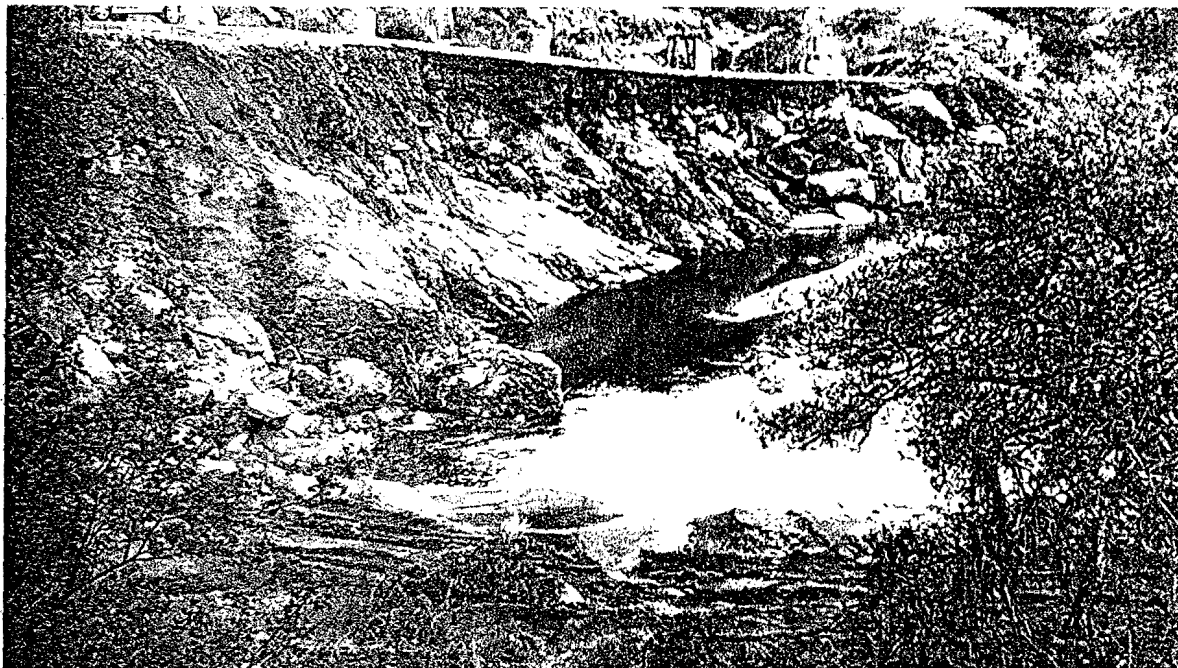
SOCAVACION EN EL TRAMO 21+520 AL 21+580
