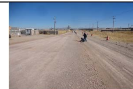
CALLE INDUSTRIAL 1, BASE HIDRÁULICA
