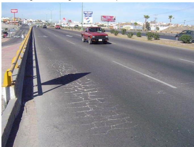
Figura 3.7 Agrietamiento piel de cocodrilo
