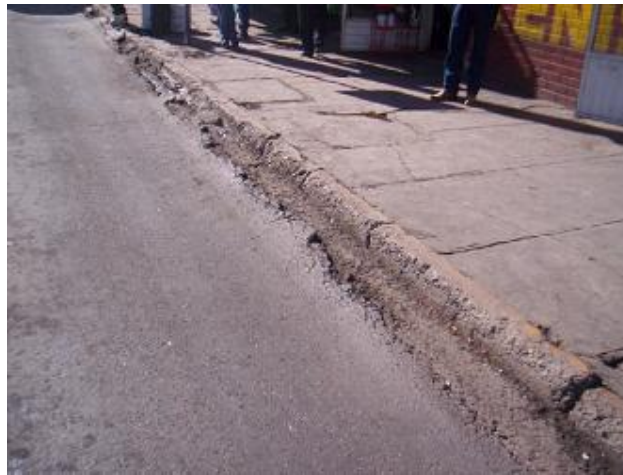
Figura 3.13 Banquetas en condiciones regulares – Av. Niños Héroes. Norte - Sur
