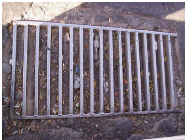
Figura 3.11 Rejilla azolvada al 100% - Av. 20 de Noviembre
